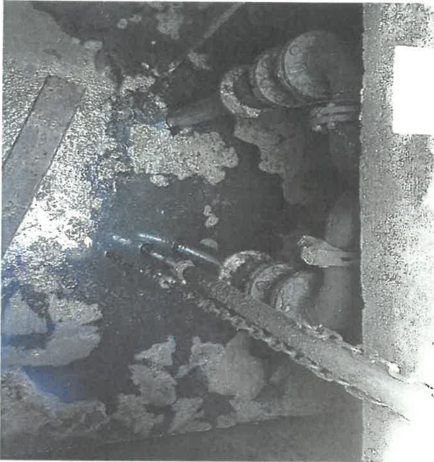
Abbildung 1: Installierte Pumpe mit Führungsstange und Zugkette
