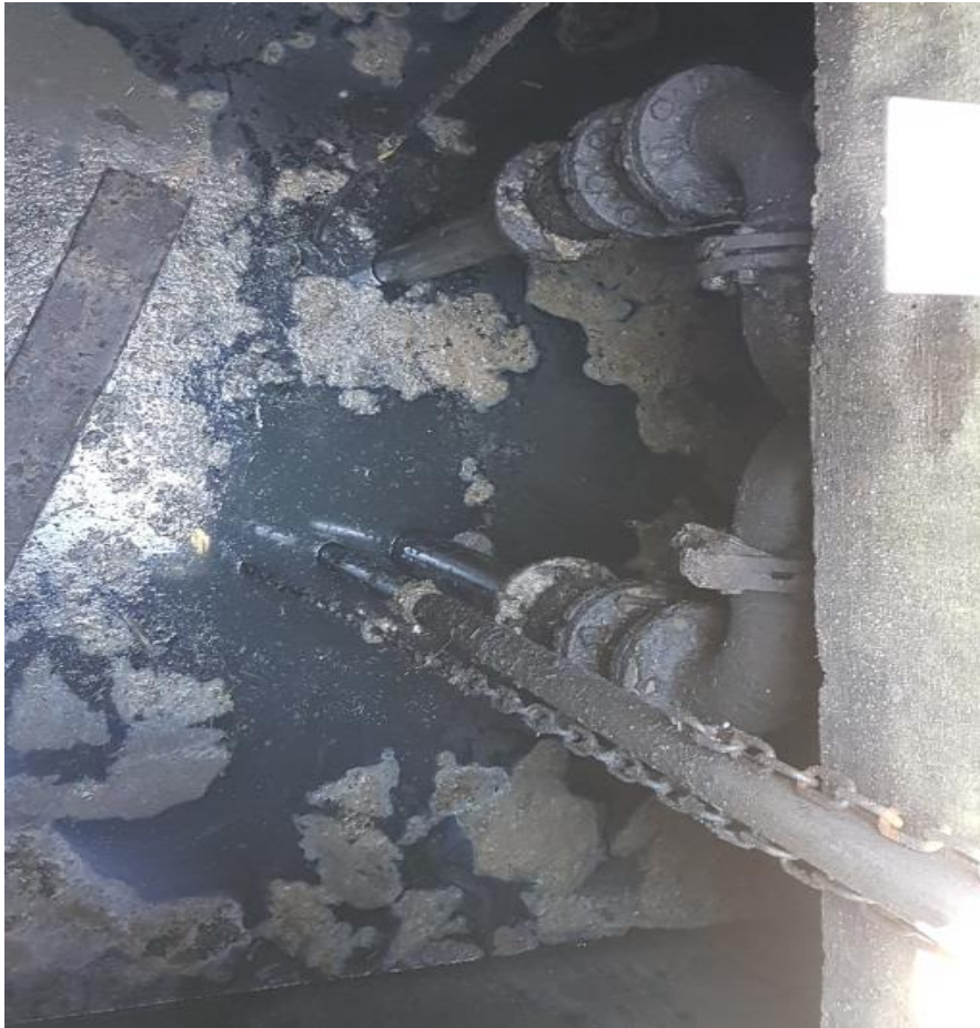
Abbildung 1: Installierte Pumpe mit Führungsstange und Zugkette
