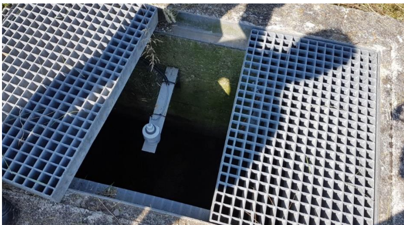
Abbildung 2: Niveaumessung Pumpensumpf (Sonde)
